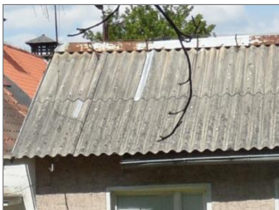
Fot.1 Płyty azbestowo-cementowe faliste
