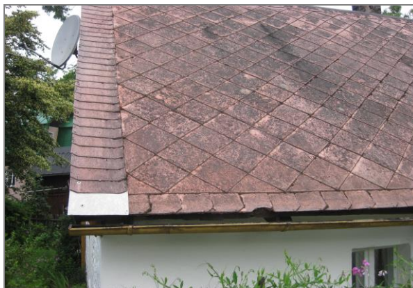
Fot. 2 Płyty azbestowo-cementowe płaskie
